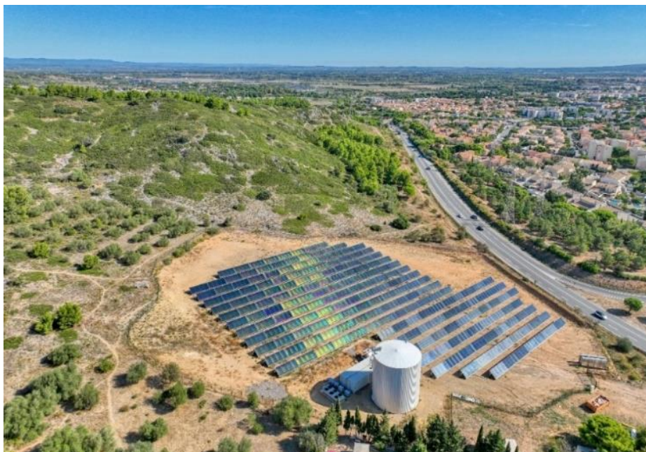
Centrale solaire thermique NARBOSOL, qui alimente le réseau de chaleur urbain de la ville de Narbonne.
